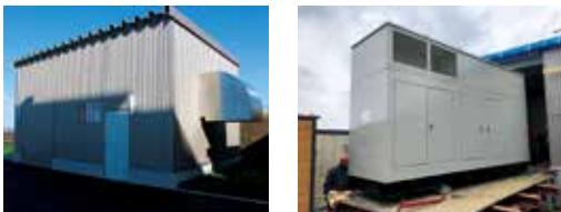
(左)防災発電棟の中に(右)非常用発電機(500KVA)が格納されています。
