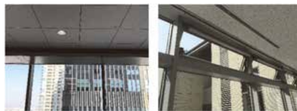
(a) 給気口の例 (b) 排気口の例 図3 給排気口の例
