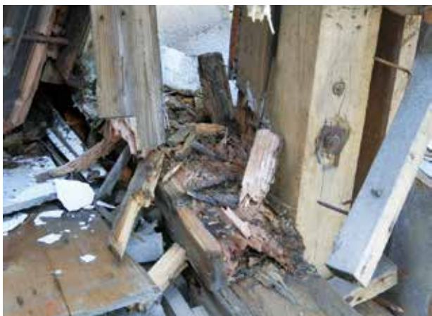
写真2 柱脚部の腐朽
