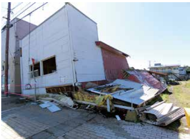
写真1 倒壊した店舗併用住宅
