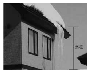
写真3 換気や断熱気密が不足し氷柱が発生している例
