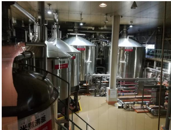
仕込槽、ろ過槽
