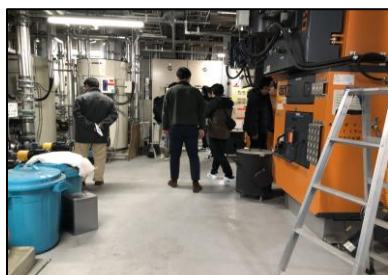
バイオマスボイラー＝浦河町
